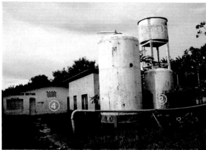
FOTO 01 – S. A. A. MUNICIPAL. Estação de Tratamento de Água. No detalhe (1) Reservatório elevado; (2) Filtro e aerador; (3) Casa de química e (4) Escritório.
