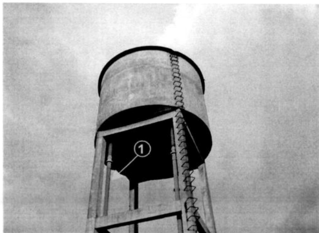
FOTO 02 – S. A. A. MUNICIPAL. Reservatório elevado. No detalhe (1) Adutora de água tratada.
