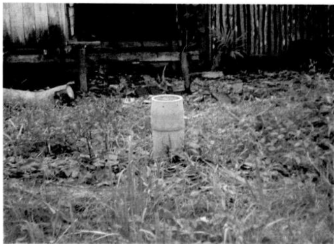
FOTO 04 – S. A. A. MUNICIPAL. Poço tubular. Observa-se a não proteção (geotampa) do poço.
